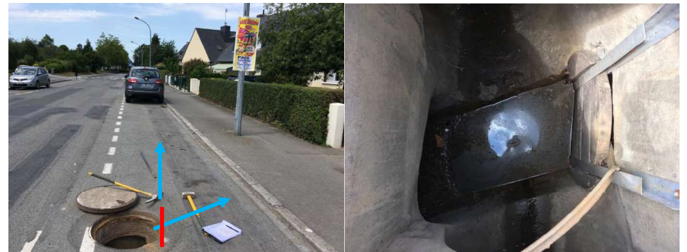
Photo 29: réseau Avenue Le Goffic - IAO SENN – 2017
