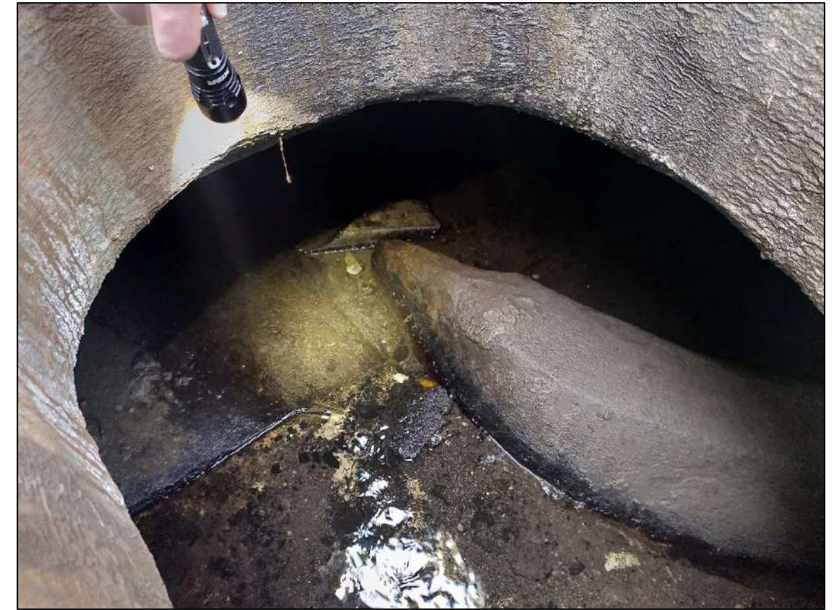
Photo 42: vue de l'ouvrage de répartition sous la route des Iles Kerguelen - IAO SENN - 2021
